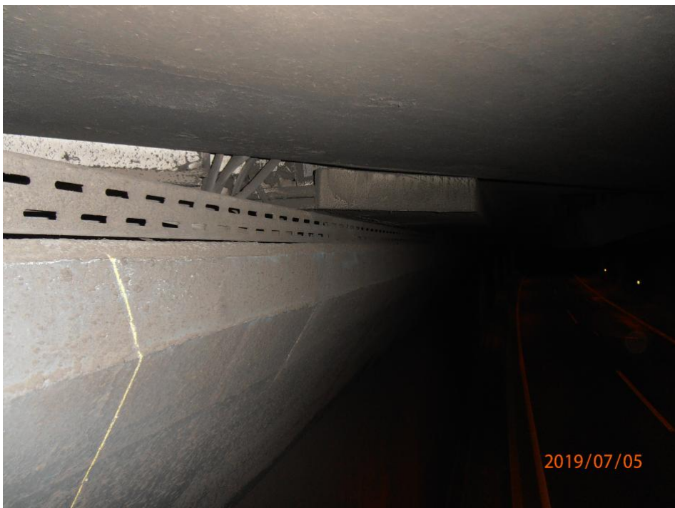
Abbildung 15 Offenes Ende Kabelkanal schräg oberhalb der Mittelwand
